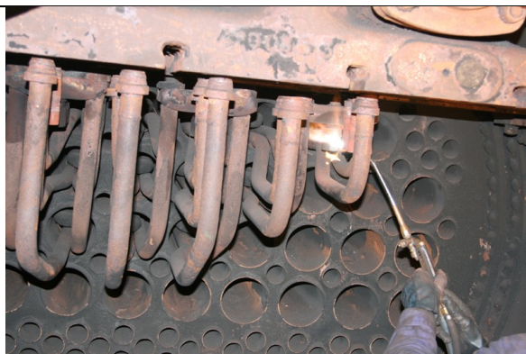
Le collecteur / Les éléments surchauffeurs
